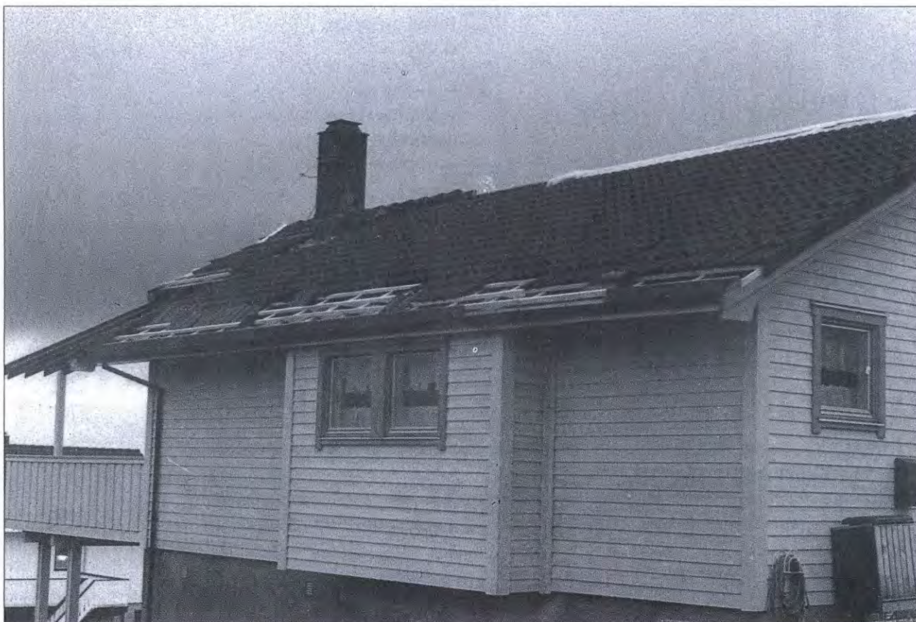
Takstein og elementpipe ble knekt – en vanlig skade på bolighus.
