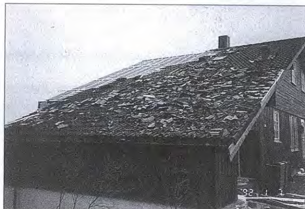
Huset ble totalskadet. Det er senere revet og bygd opp på nytt.
