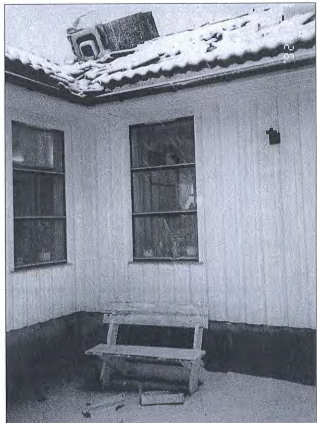
Avblåst pipe på bolighus
