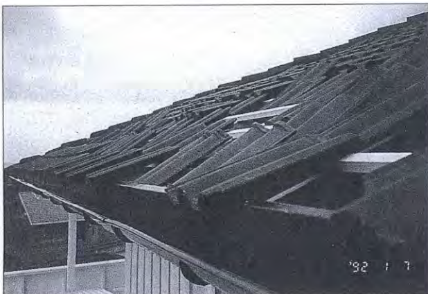
Betongtakstein er løftet på og siden revet løs.
