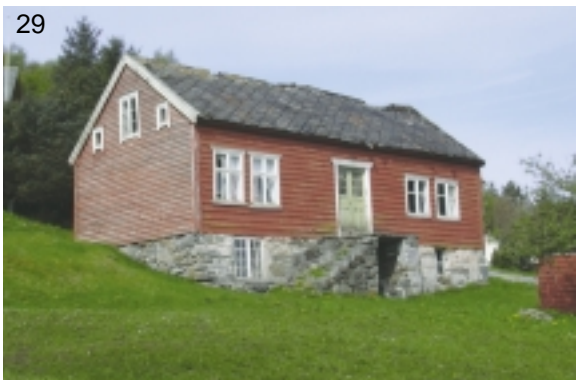
Empire- hus frå Flusund i Herøy. Huset er sterkt prega av forfall, men let set enno berge.
