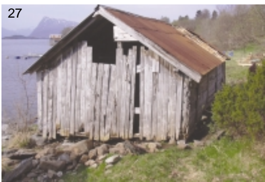
Årsak til forfall er ofte at det gror til langs veggen nede.
