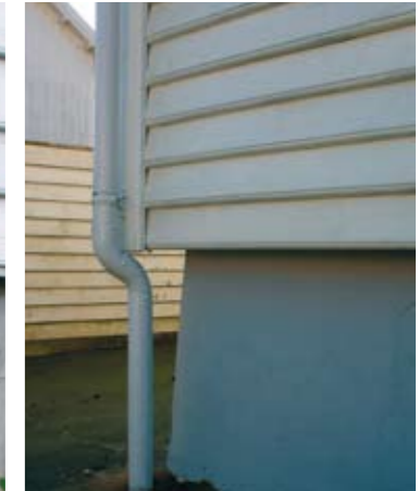
Eksempel på for stor utlekting
