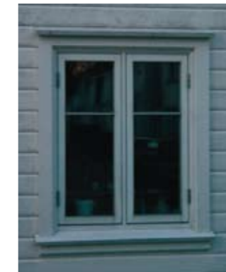
Nytt vindu med "falsk" krysspost. Her er sprossetykkelsen feil.
