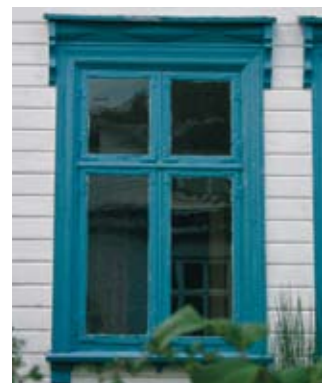
Krysspost, fire-rams, ingen sprosser. Ytre Sandgate 23b. Dette vinduet er nå byttet ut.
