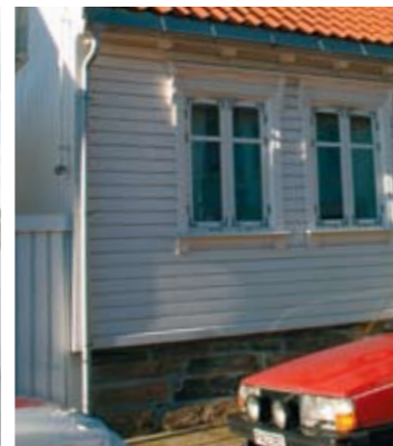
Ny, lakkert stålrenne m/rennekroker og nedløp. Mellomgata 8
