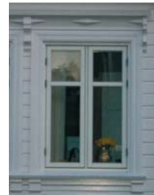
Nytt vindu med "falsk" krysspost. Johnstons gate 24
