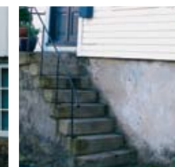
Ubehandlet pusset grunnmur. Giert Giertsens gate 20
