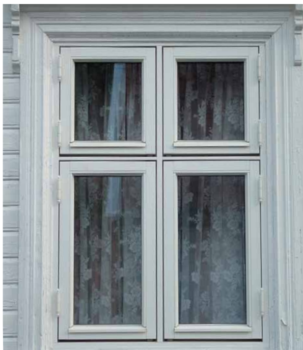
Nytt vindu. Misforhold mellom glassareal og ramme
