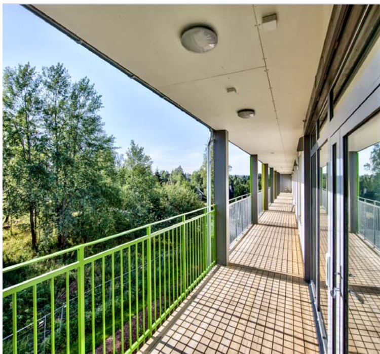
Figur 3: Bilde som viser svalgang med horisontalt utformet himling over svalgang som vil gi gode forutsetninger for fri utlufting av røyk (foto: Selvaag Bolig).
