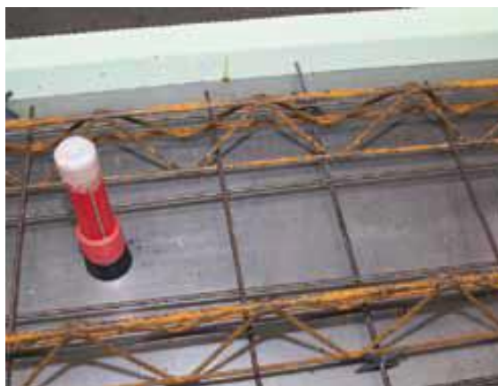
Figur 49: Plattendekke levert med sprinklerpunkt innstøpt (Aquatherm GmbH, 2013).
