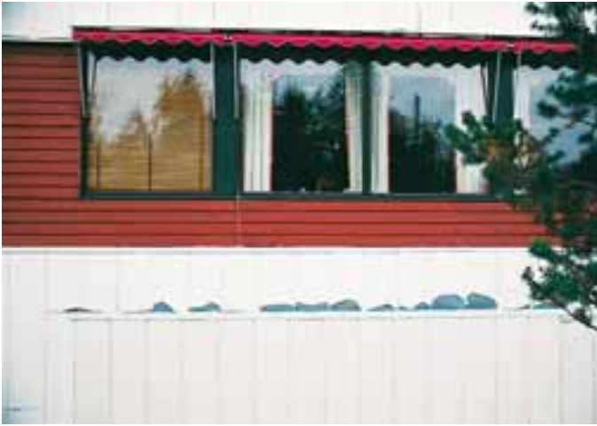
Ikke alle materialer holder hva de lover. Slike skader lar seg ikke utbedre.
