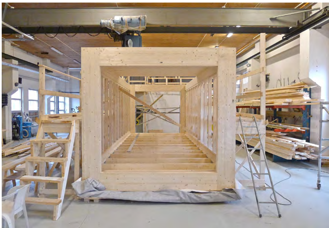
Byggmodulen under produksjon i slutten av oktober 2012. Bildet viser endevegg med avstivende limtramme som gir stor frihet i utforming av fasade og vindusløsninger. Bærende tredekke i tak er delvis ferdigstilt.
