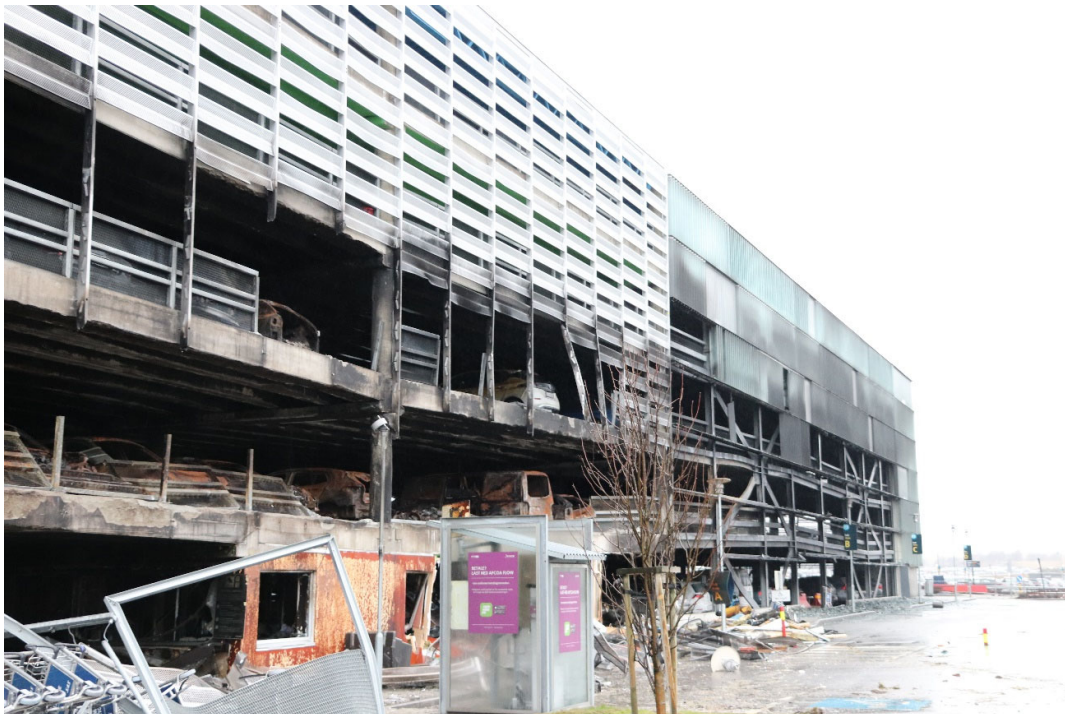
Figur 3-2 Parkeringshusets nordøstre fasade etter brannen. Venstre halvdel viser B mens høyre halvdel viser bygning C.
