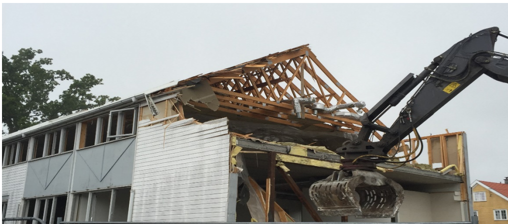
K-virke, panel og takstoler, synliggjort ifb. Riving av et bygg på holtet i Oslo i 2017. (Foto Resirqel AS.)
