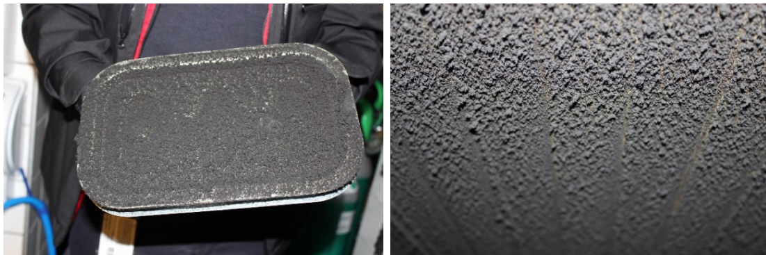
Figur 3-16 Oppsamling av sot inne i avtrekkskanal for kullgrill. Kanal blir vasket en gang per år av et eksternt firma. Når bildet er tatt er det snart ett år siden sist rengjøring. Ifølge restauranten er dette lite sot sammenlignet med hva de opplevde før de installerte UV-filer.
