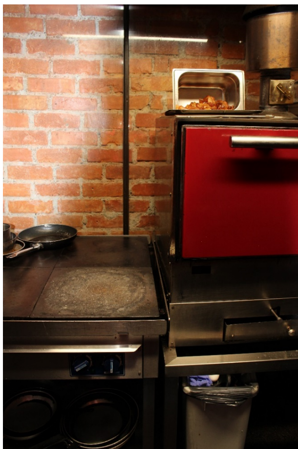
Figur 3-11 Stekeplate med høy temperatur plassert ved siden av kullgrill.
