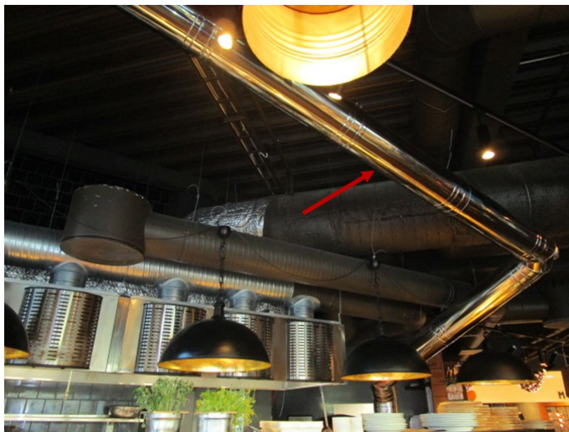
Figur 3-5 Løsning for separat avtrekk for grill med fast brensel (blank, mantlet kanal på skrå markert med pil i bilde). Foto av Optice AS, gjengitt med tillatelse.
