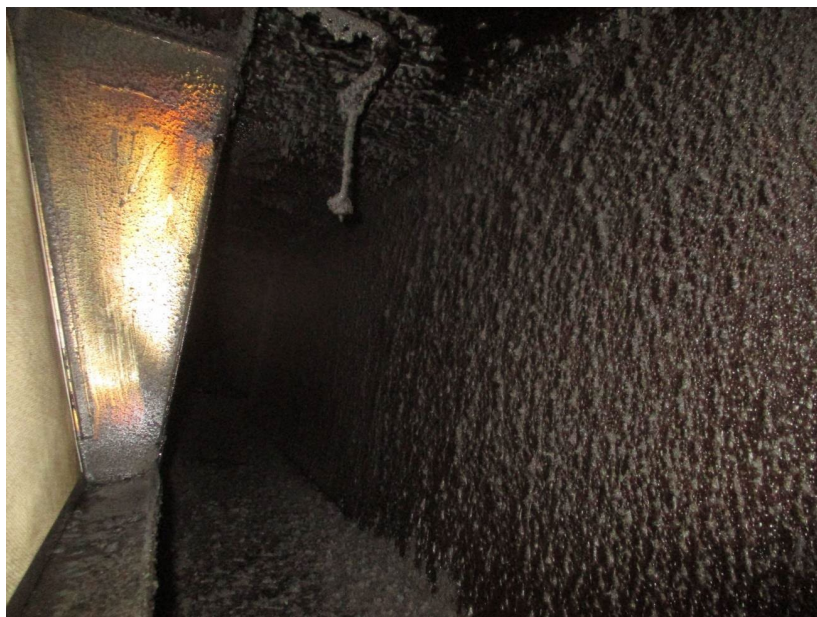
Figur 3-1 Kjøkkenavtrekk som betjener en lukket kullgrill, en friturekoker og en stekeplate, et år etter rengjøring. Foto av Optice AS, gjengitt med tillatelse.
