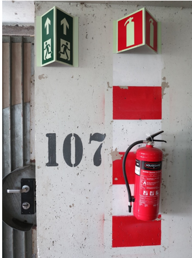
Figur 3-9 Etter en tidligere brannrådgivning ble rømningsveier og brannslukkere tydeligere merket. Det finnes fire håndbrannslukkere i hver etasje.
