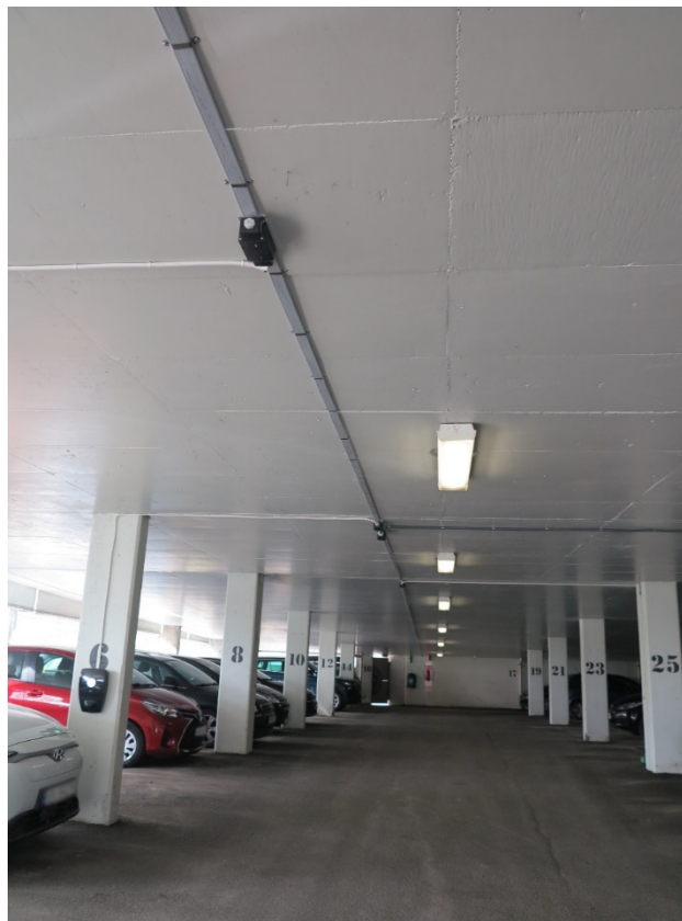
Figur 3-5 To hovedkabler i hver etasje forsyner ladeboksene med strøm (flat kabel i tak, midt i bilde). Fra hovedkabel blir det trukket ledninger til ladebokser. Strømanlegget har kapasitet til at alle parkeringsplasser skal kunne koble seg til ladesystemet. Bileier velger selv om de vil koble seg til systemet, men om det skal lades kjøretøy i garasjen må man koble seg til systemet.
