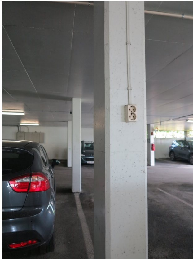
Figur 3-4 Før installasjon av ladebokser ble stikkontakter beregnet for motorvarmere brukt til lading av elbiler. Etter installasjonen av ladesystemet har det blitt innført forbud mot å lade bil via stikkontakt.
