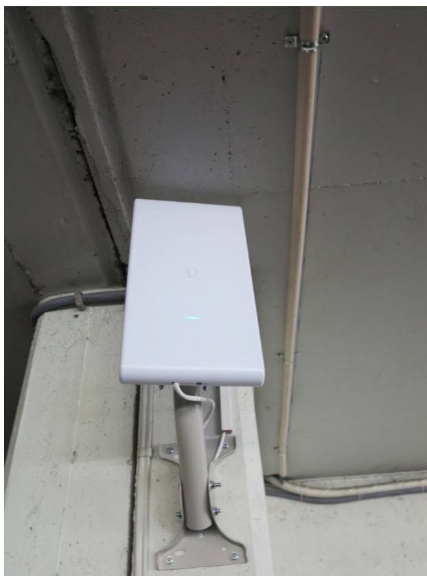
Figur 3-8 Trådløst nettverk sørger for at ladingen av bilene kan styres av det dynamiske ladesystemet.
