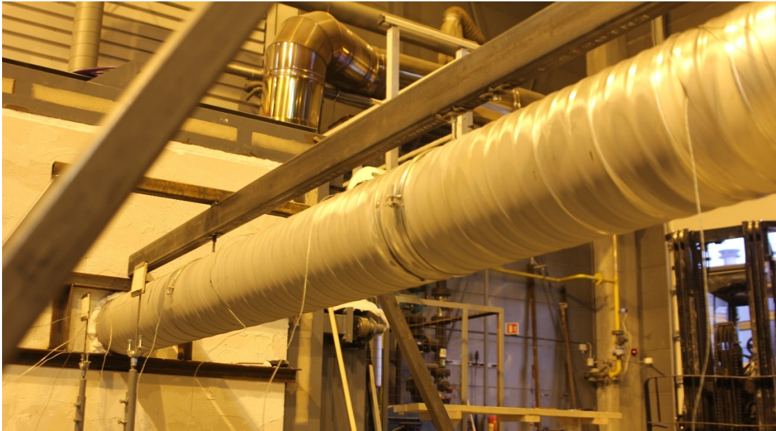
Figur 4-10 Kanalen på bildet hadde 2,4 m avstand mellom hvert opphengspunkt, og det var ingen tegn til deformasjon eller skader på kanalen etter test. Bildet er fra test R5.
