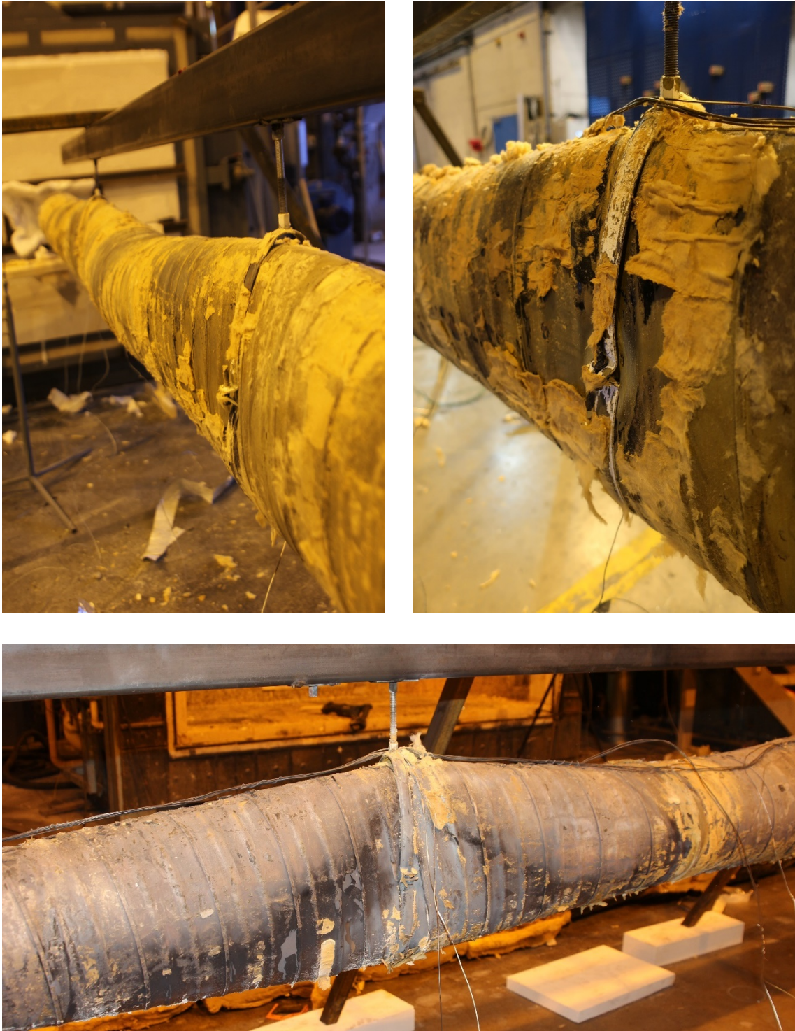
Figur 4-17 Kanalen har blitt kraftig deformert i opphengspunktene. Bildene er fra test R4.
