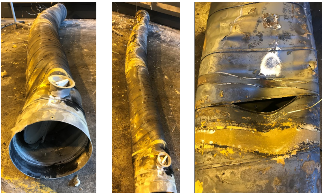
Figur 4-16 Deformasjonen av kanalen ble synlig etter at isolasjonen ble fjernet. Bildet er fra test 7.
