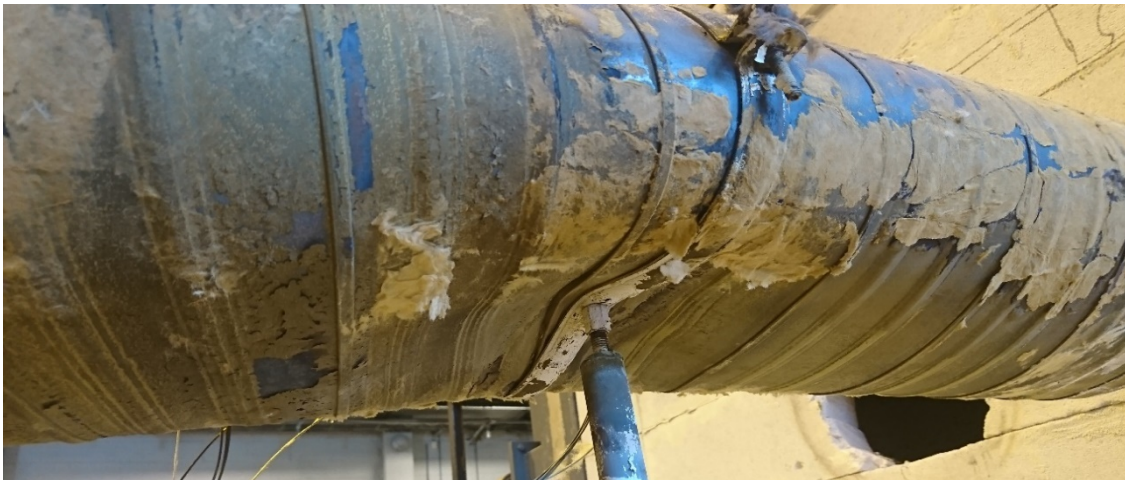
Figur 4-15 Kanalen var tydelig deformert etter endt forsøk. Bildet er tatt etter at isolasjonen ble fjernet, og er fra test 27.
