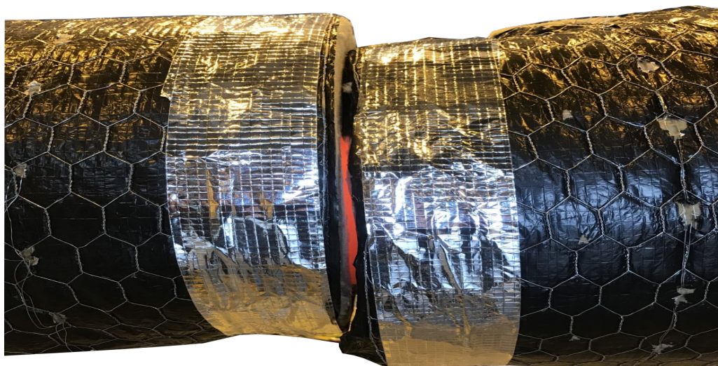
Figur 4-12 Bildet viser at ventilasjonskanalen er rødgldende bak isolasjonen. Kanalen har fått enn liten knekk, som vist ved at to isolasjonsmatter har blitt forskjøvet i forhold til hverandre. Bildet er fra test 22.
