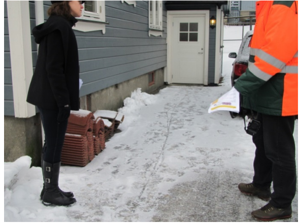
Foto 2 (SINTEF Byggforsk) Utenfor inngangsparti. Tett overflate med lite fall fra huset. Ingen fornyet drenering synlig.
