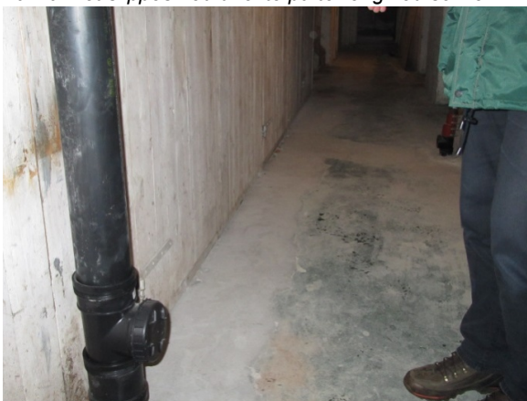
Foto 5 (SINTEF Byggforsk) Fra innvendig kjellergang midt i bygningen. Her ligger fornyet avløpsrør. Spor i golvet viser at det er gjennomført tiltak. Kjellerveggene er av støpt betong. Kjelleren har vært utsatt for vann ved flere tilfeller, men det er ikke synlige skader på vegger eller betonggol.
