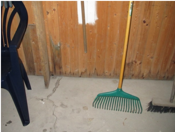
Foto 8 (SINTEF Byggforsk) De er synlige merker etter oppfukning i nedre del av delevegger av tre. Det kan være en fordel å skille de skadeusatte organiske materialene fra underlaget slik at det er lettere å tørke ut etter en vanninntrenging. Veggene kan eksempelvis monteres på oppklossing av fuktbestandig materiale. Alternativt unngå å bruke treverk.
