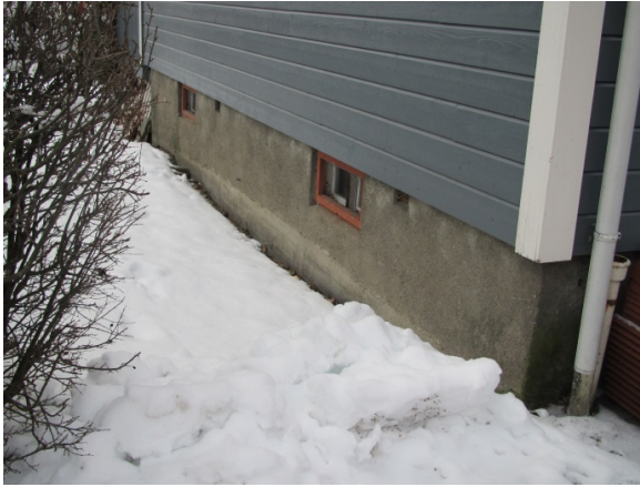
Foto 1 (SINTEF Byggforsk) Dårlig fall på terreng fra huset. Vi ser også at nedløpsrøret fra tak er koblet bort fra røret som går under terreng. Takvannet slippes rett ned på bakken ved sokkelen. Vannet burde ha vært ledet bort fra bygningen. Ingen tegn på at dreneringen er fornyet.
