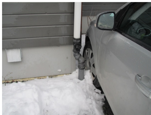
Foto 28 (SINTEF Byggforsk) Nedløp tilkoblet kommunalt overvannssystem
