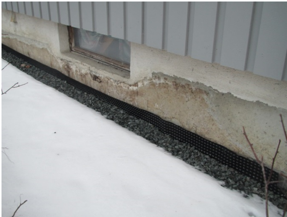
Foto 12 (SINTEF Byggforsk) Foto viser endret terrengutforming langs gavlveggen.
