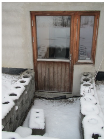
Foto 16 (SINTEF Byggforsk) Utsatt kjellerinnngang uten beskyttende takoverbygg. Stor risiko for vannansamling utenfor og inntrenging av vann ved sterk nedbør eller snøsmelting
