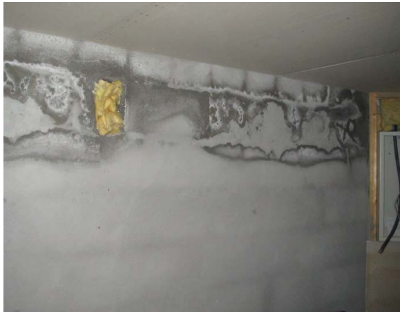
Foto 18 (SINTEF Byggforsk) Tydelige spor av fuktinntrenging i øvre del av kjellerveggen
