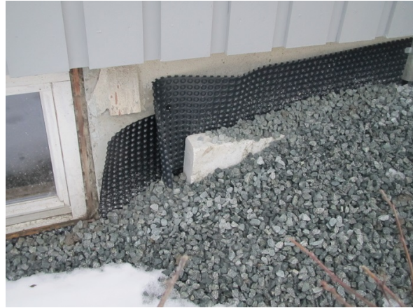
Foto 11 (SINTEF Byggforsk) Ny drenering med montering av grunnmursplater og tilbakefylling med drenerende masser.
