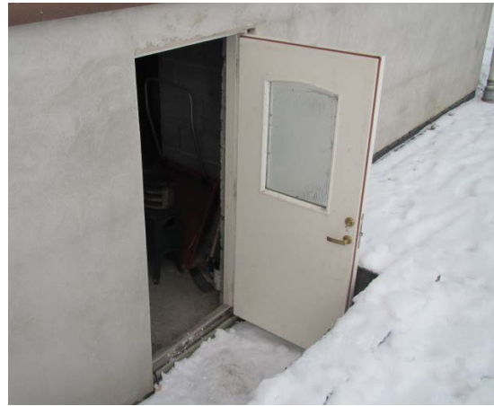
Foto 19 (SINTEF Byggforsk) Kjellermedgangen er utsatt for vanninntrenging hvis den ikke holdes fri for snø og is om vinteren. Det er dårlig fall på terrenget rundt bygningen.
