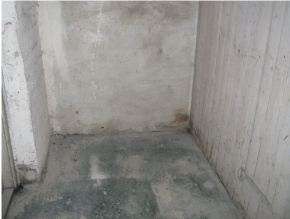
Foto 6 (SINTEF Byggforsk) Typisk rom i kjeller. Treveggen til høyre har merker etter oppfukning i underkant. Ellers ikke noen alvorlige skader.
