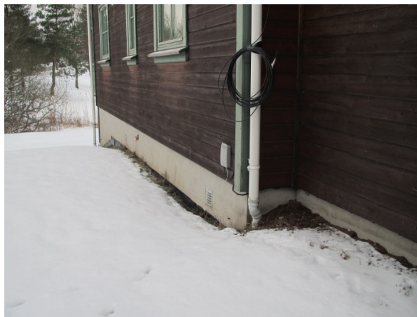
Foto 17 (SINTEF Byggforsk) Taknedløp går ned i terrenget. Ikke noe fall fra terrenget bort fra bygningen.
