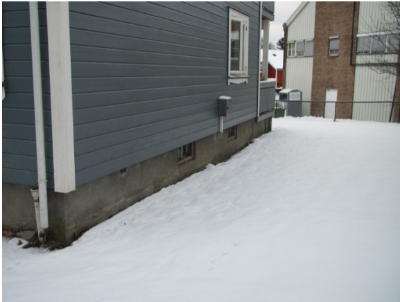
Foto 3 (SINTEF Byggforsk) Tilsvarende situasjon som på foto 1 og 2. Lite fall på terreng fra bygningen. Ingen tegn på fornyet drenering. Takvannet slippes ned direkte på terreng ved sokkel.
