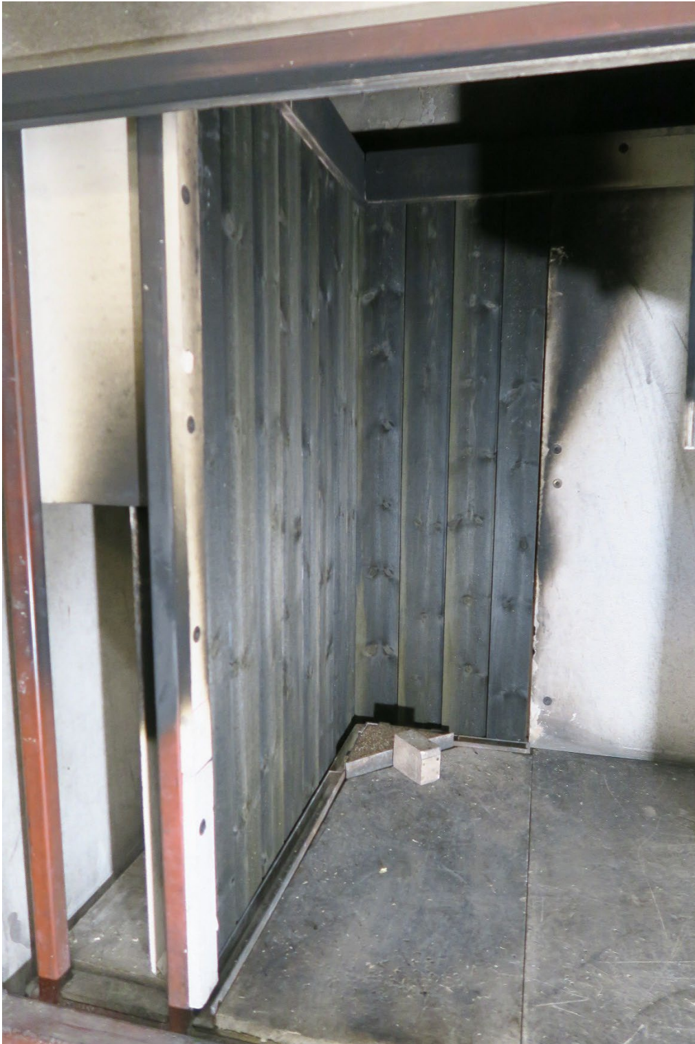
Foto nr 2 Före provning "N"
